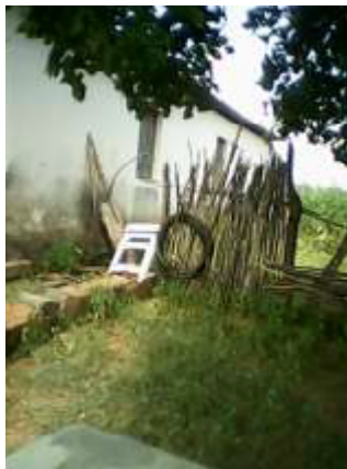
Figura 161 - Lateral da casa abandonada
