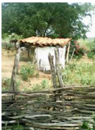
Figura 163 - Detalhe de banheiro e chiqueiro abandonados
