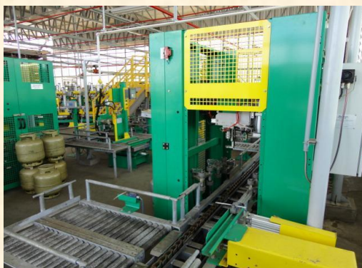
Figura 26 – Máquina de verificação de vazamento.
