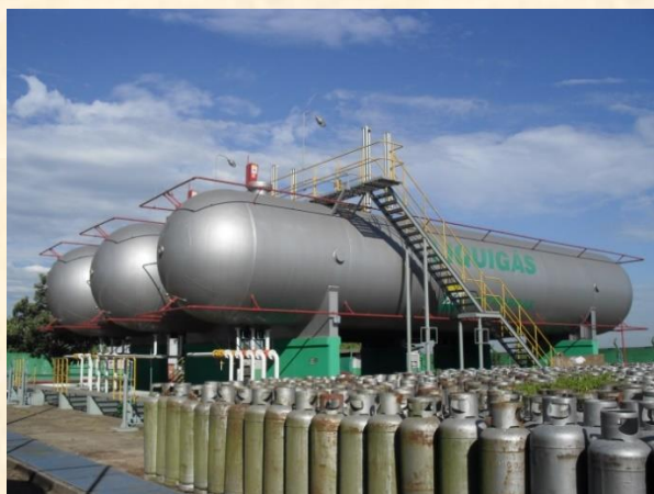
Figura 10 – Tanques de armazenamento.
