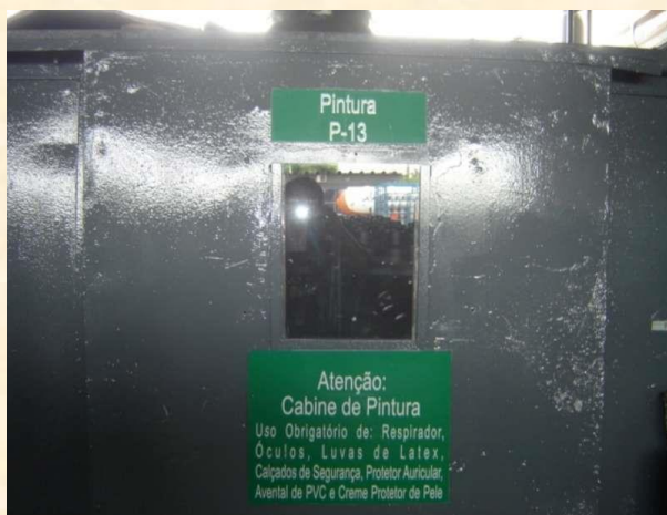
Figura 29 – Cabine de pintura de botijões.
