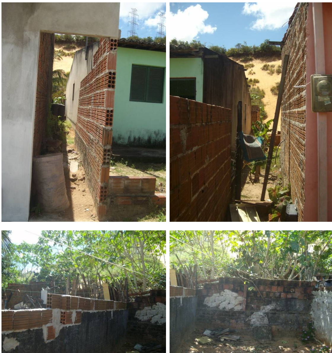
Figura 113: Fotos expõem o padrão construtivo das unidades do assentamento próximos as dunas. Fonte: Idesplan.
