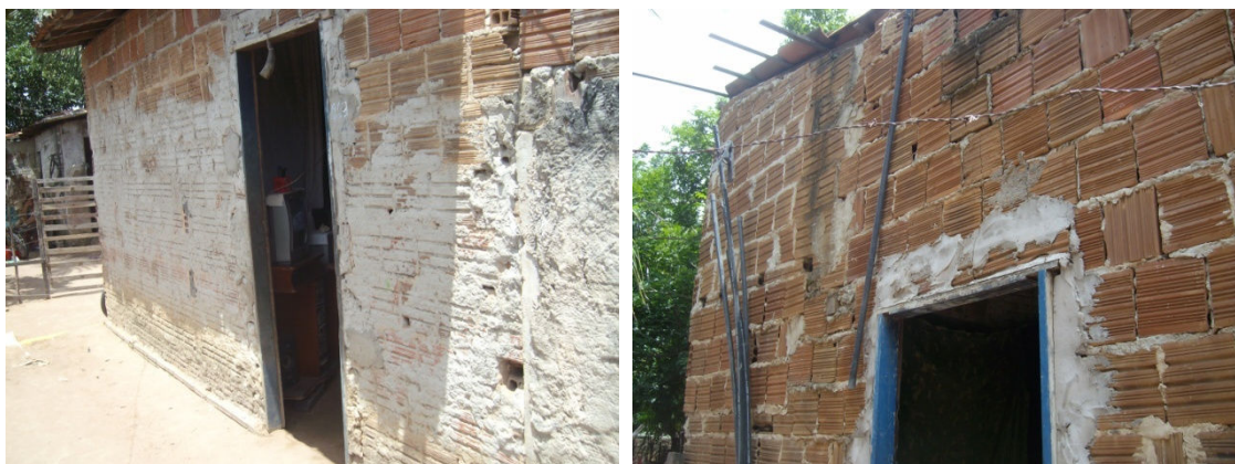
Figura 296: Exemplo de moradia com problemas estruturais graves. Fonte: Idesplan.
