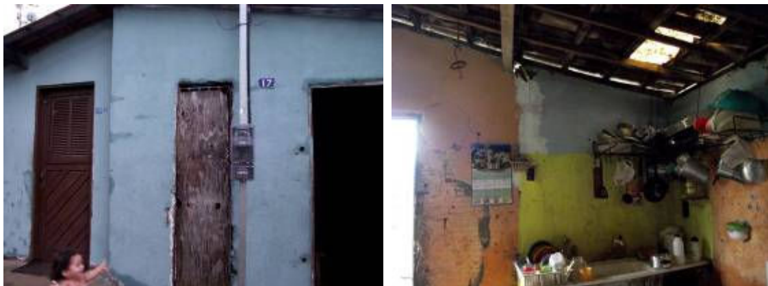
Figura 322: Moradias com o padrão habitacional precário, com problemas na estrutura e utilização de alguns materiais improvisados. Fonte:Idesplan.
