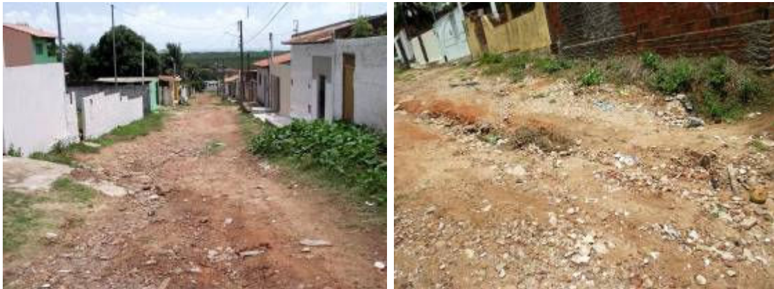
Figura 309: Rua com problemas de alagamento apresenta solo bastante desgastado e com a formação de uma ravina. Fonte: Idesplan.
