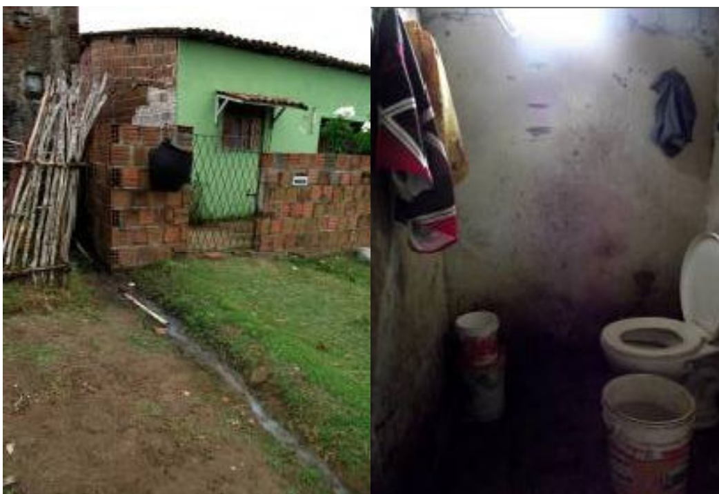
Figura 323: Moradia passível de adequação, em alvenaria, e banheiro com instalações precárias. Fonte:Idesplan.
