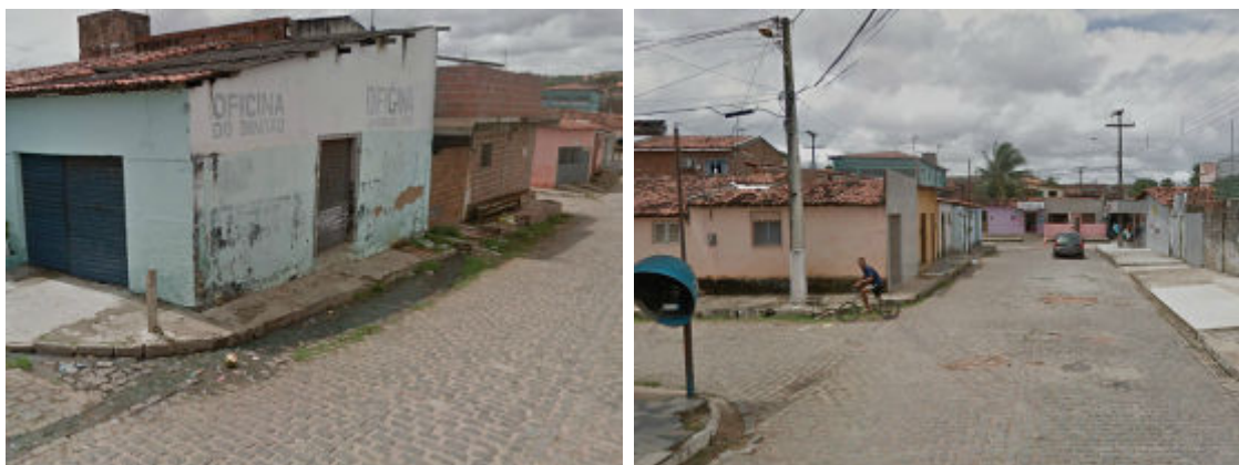
Figura 141: Esgoto a céu aberto e rua com problemas na pavimentação. Fonte: Google Street View.
