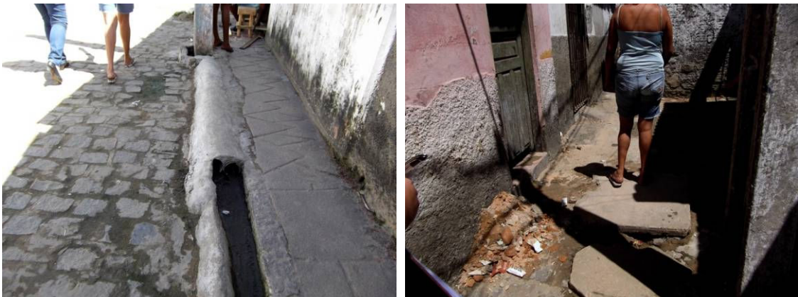
Figura 268: Escoamento de águas servidas e pluviais. Sistema precário. Comunidade Beira Rio. Fonte: Idesplan.
