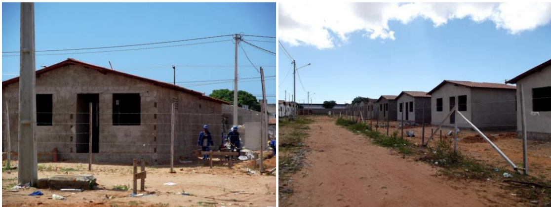
Figura 89: Fotos das moradias em processo de construção da Comunidade Wilma Maia. Fonte: Idesplan.
