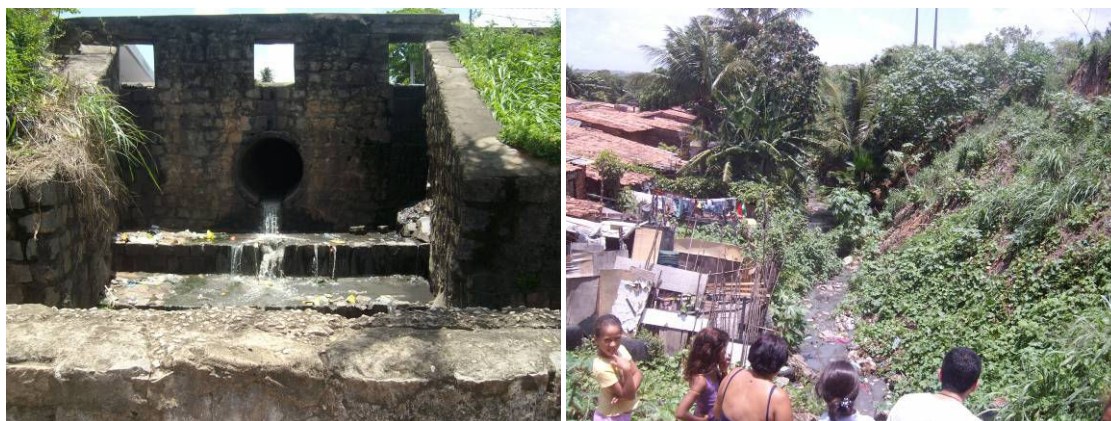
Figura 36: Esgoto despejado em córrego margeando as residências. Fonte: Idesplan.
