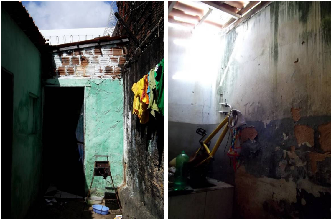
Figura 199: Edificações comprometidas lindeiras ao muro do Porto. Maruim. Fonte:Idesplan.
