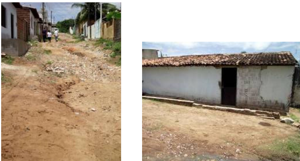
Figura 313: Padrão habitacional predominante com casas de alvenaria e de um pavimento e casa apresentando problemas na estrutura. Fonte:Idesplan.
